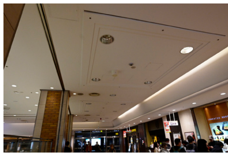
天井にはコンパクト蛍光灯用の穴が多く残っている
