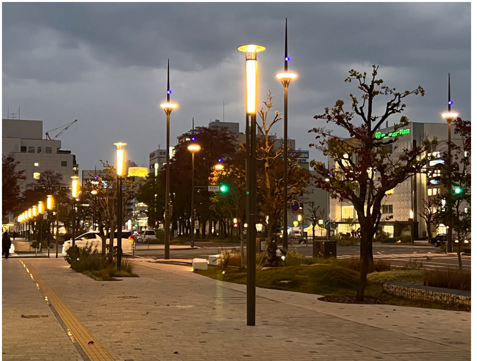
整備された中央通りには3000Kで統一された街路灯が2列並び、上部には交通信号に見間違いそうなインジケータ
